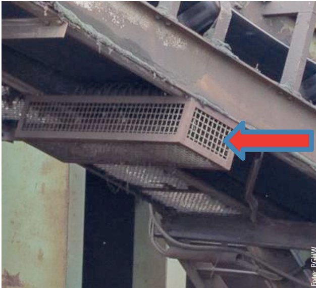
Mit Verkleidung (Pfeil) gesicherte Untergurtrolle
