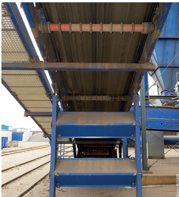
Ungesicherte Untergurtrollen eines Bandförderers
