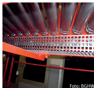
Absicherung eines Königswellenantriebs durch Lochblech
