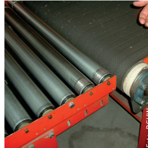
Die Auflaufstelle zwischen Gurt und Trommel ist mit einem durchgehenden Blech gesichert; aber es besteht auch eine Einzugsstelle zwischen Bandförderer und nachfolgend angeordneter Rollenbahn
