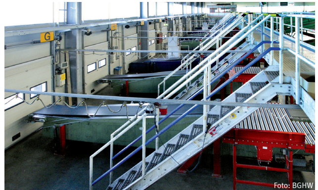
Rollenförderer in einem Verteilzentrum. Als Zugang zu den Arbeitsplätzen sind sichere Verkehrswege vorzusehen.
