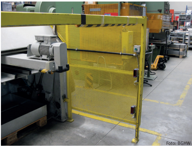
Rückseitiges Schutzgitter mit zwei Lichtschranken in verschiedenen Höhen Foto: BGHW
