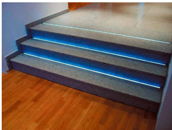
Bild 1: Die Stufen im Verlauf des Verkehrsweges sind durch Beleuchtung leicht erkennbar.
